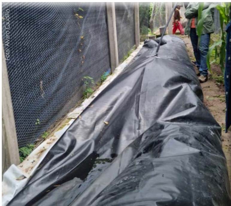
Foto: Alvaro Caudillo Así se observa el biodigester que instalaron en una vivienda de la Montaña de Guerrero
